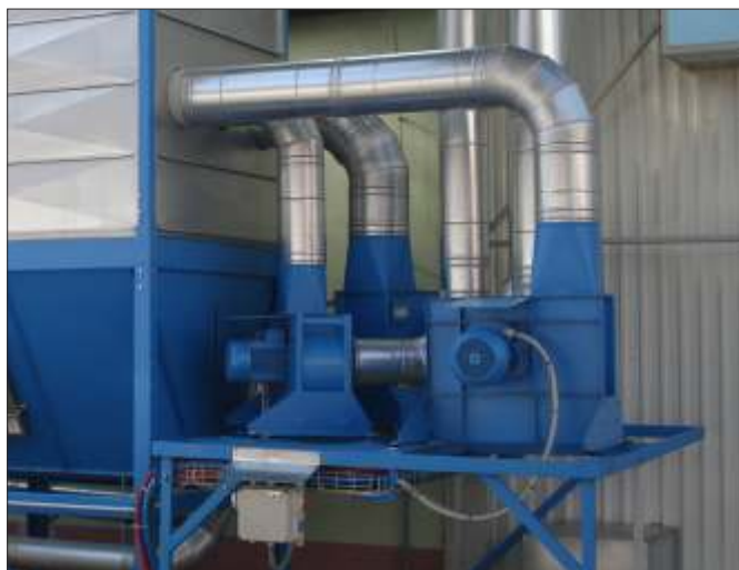
• Odsávací ventilátory typu VSM instalované ve firmě Devospol Štábný (Zaháj, R)
